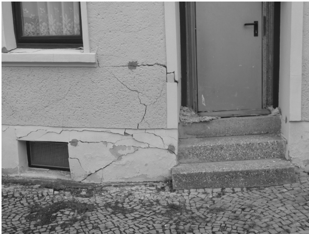
Bild 1.1 Risse an einem Wohngebäude infolge von Untergrundverformungen
