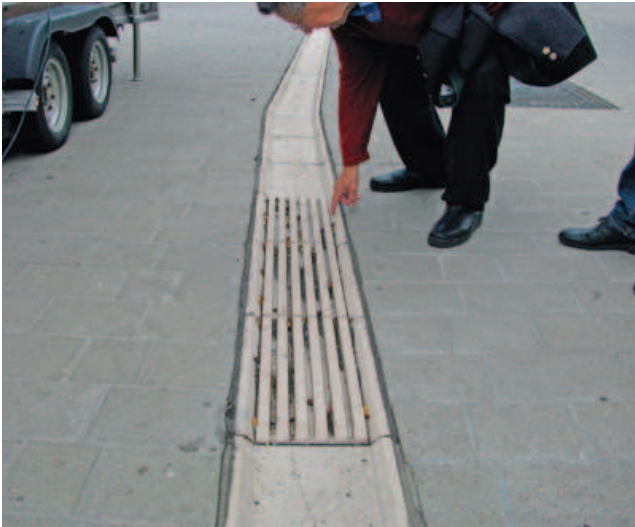
Abb. 6.6: Muldenrinne, dient zur Entwässerung und Blinden zur Orientierung. Mit dem Rollstuhl ist eine tiefe Rinne aber nur schwer zu queren, deshalb wurde die Tiefe mit Rippen als Querungshilfe verringert. (Quelle: Armin Schulz, Mainz)
