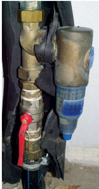
Abb. 6.5: Rückspülfilter für eine Trinkwasseranlage als Schmutzfänger für die Sole eingesetzt (Foto: Hans-Jürgen Seifert)
