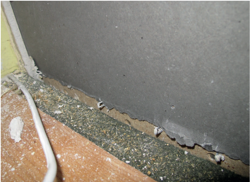
Abb. 10.21: Die Luftdichtheitsschicht war am Fußbodenanschluss nicht luftdicht ausgeführt
