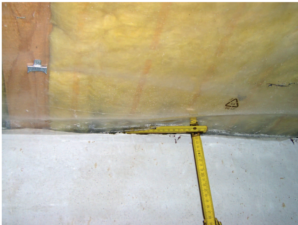
Abb. 10.20: Der Wandanschluss der Luftdichtheitsschicht war nicht dicht ausgeführt worden
