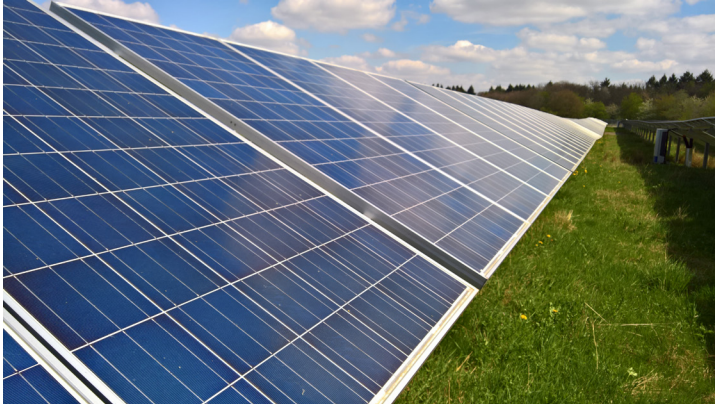
Bild 7.1 PV-Generator einer Freiflächenanlage
