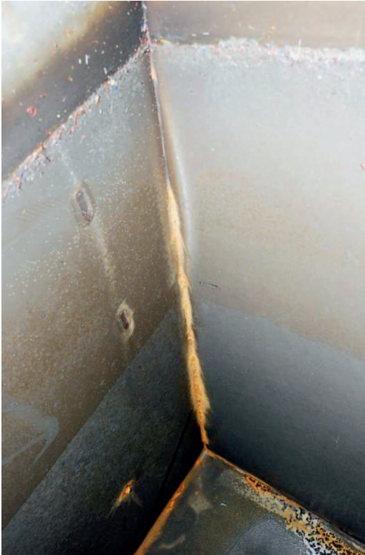
Falsch: Korrosion an den Schweißnähten (Innenseite).
