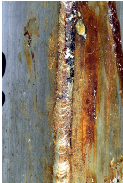
Falsch: Detail der Schweißnaht von außen. Deutlich ist der starke Korrosionsangriff zu erkennen.
