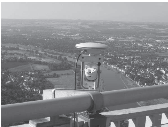
Abb. 1.5: Reflektor und GNSS-Antenne zur Turmüberwachung
