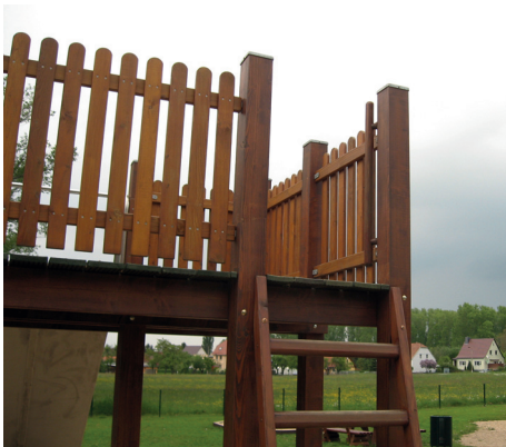
Bild 12: Negativbeispiel: besteigbare Brüstung. (Quelle: GAO – Gesundheits- und Arbeitsschutz Onischka UG [haftungsbeschränkt].)
